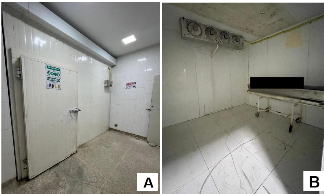
Figura 12 – Porta da câmara fria (A) do PML de Governador Valadares, acompanhada de uma placa de aviso que indica o uso obrigatório de EPI (Equipamento de Proteção Individual) e do interior da câmara fria (B) mostrando uma maca em que há um corpo refrigerado em seu interior.
