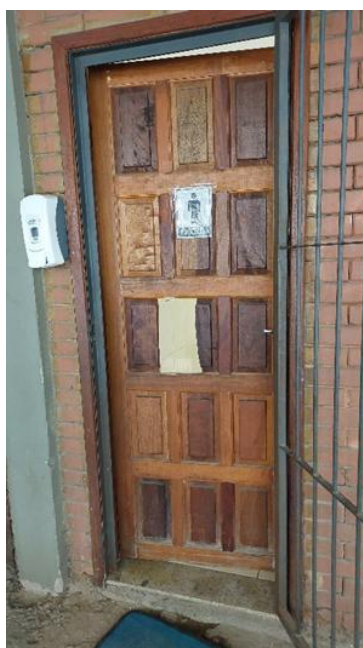
Figura 8 – Porta do banheiro masculino danificada (com um buraco na porta que possibilita ver dentro do banheiro mesmo com a porta fechada)
