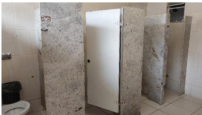
Figura 10 – Porta das cabines do banheiro masculino danificadas, impedindo que sejam usadas com uma privacidade
