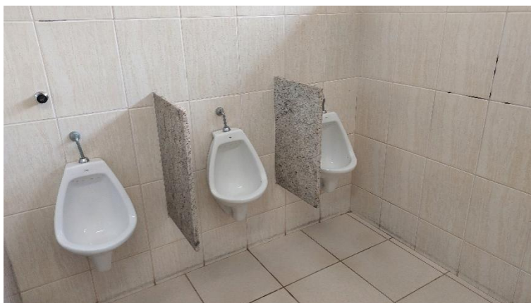
Figura 11 – Mictório coletivo posicionado de frente às cabines no banheiro masculino
