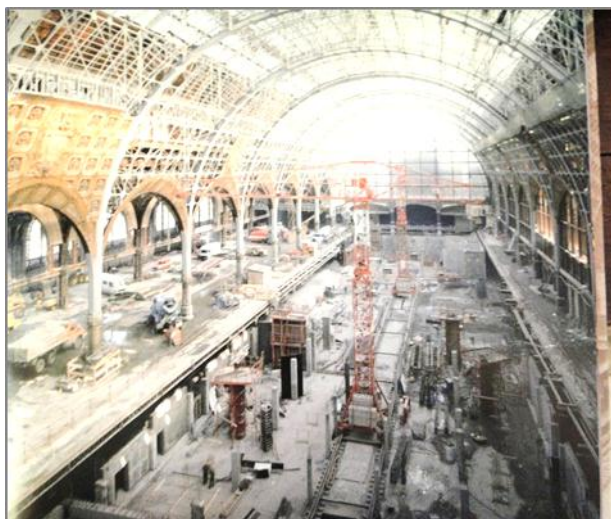
Figura 10: Obra de restauração e adaptação para novos usos da antiga Gare Fonte: Livro “La gare d’Orsay the Orsay station” - Museu d’Orsay, pág. 23
