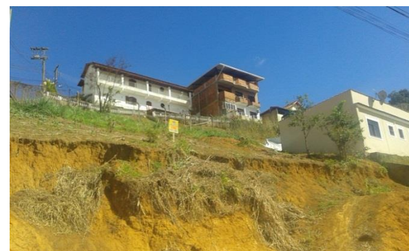
Figura 4: Imagem obtida da Rua Sebastião Costa Leite, mostrando a ocupação em uma encosta com o solo exposto e com registros de erosão causados por cortes no talude.
