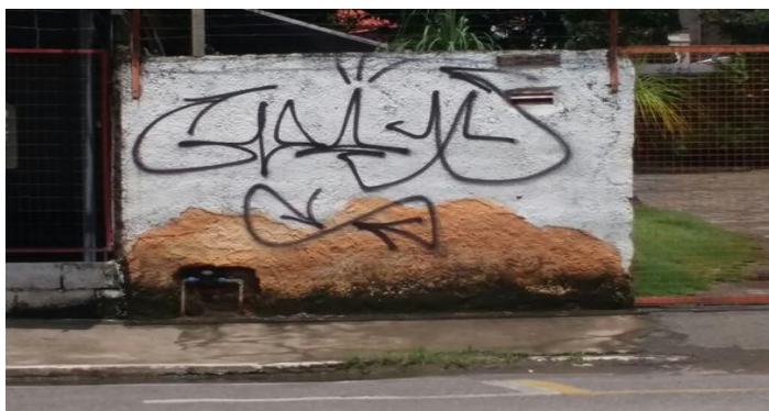
Figura 7: Muro pichado, Avenida Raul Soares
