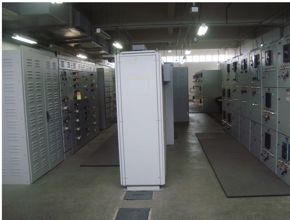
Figura 4 – Subestação de Unidade – Vista interna - Refinaria de Petróleo.
