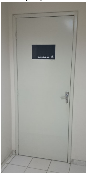
Figura 75 – Porta do sanitário unissex para pessoa com deficiência sem a chapa de proteção.
