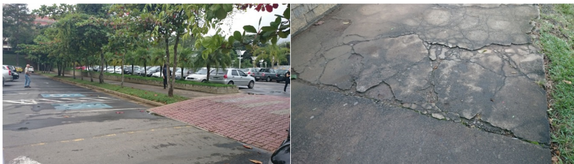
Figura 37 – Passarela de pedestres entre os estacionamentos 2 e 3 (A), com piso danificado (B).
