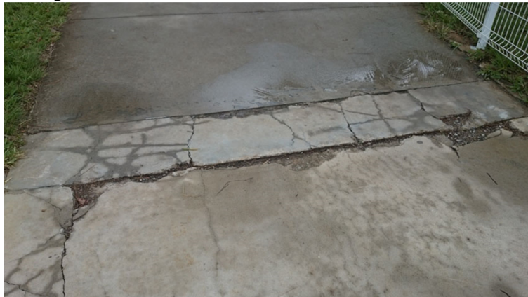
Figura 35 – Piso danificado ao lado do Jardim Sensorial.
