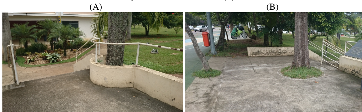
Figura 58 – Árvore comprometendo a largura do patamar da escada (A), e outra obstruindo acesso a parte do lance da escada (B).
