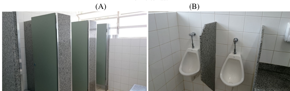
Figura 81 – Vista das cabines (A) e mictórios (B) do sanitário masculino, no corredor esquerdo das Pró-Reitorias.
