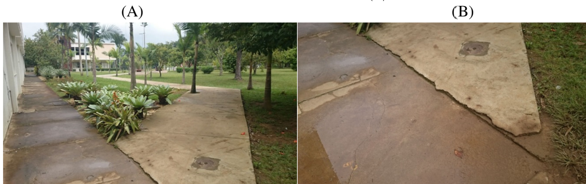
Figura 36 – Passarela de pedestres do Jardim Sensorial à entrada principal (A), com destaque para o desnível no final da mesma (B).
