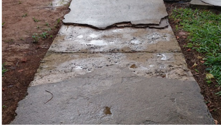
Figura 55 – Piso da rampa danificado próximo ao Jardim Sensorial.
