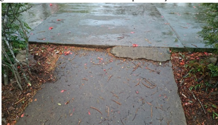
Figura 54 – Desnível de 6cm entre a rampa e a calçada do anel viário.
