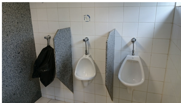
Figura 84 – Mictórios do sanitário masculino de funcionários próximo ao de pessoas com deficiência.
