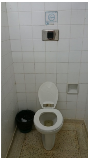
Figura 71 – Vista do interior da cabine do sanitário feminino de alunos do pavimento térreo.
