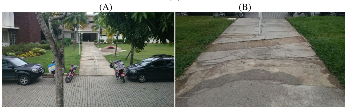
Figura 39 – Passarela de pedestres da via de veículos ao acesso secundário (A), com piso danificado (B).
