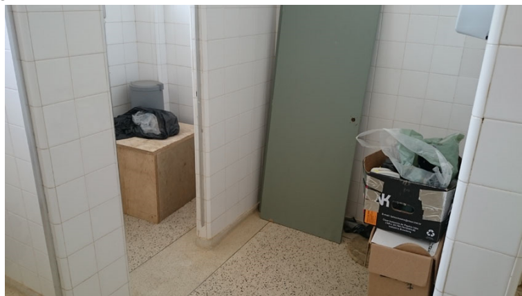
Figura 76 – Sanitário desativado no corredor direito das Pró-Reitorias.
