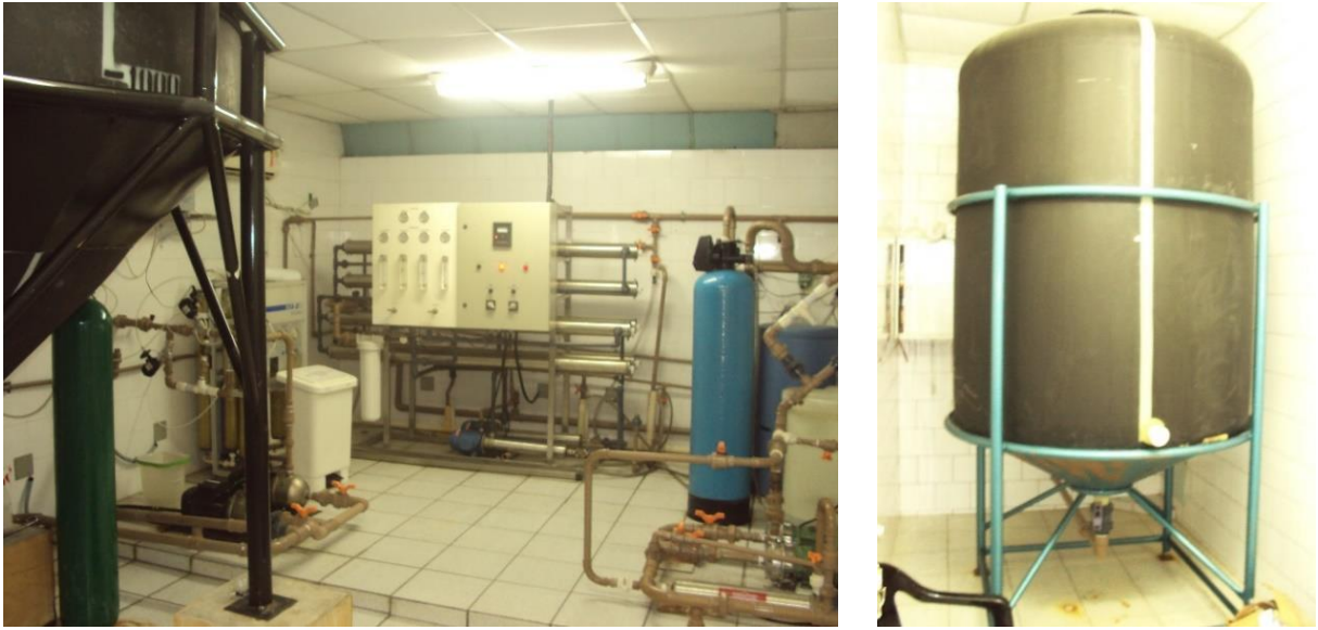
Figura 37– Tratamento de água da Clínica 1
