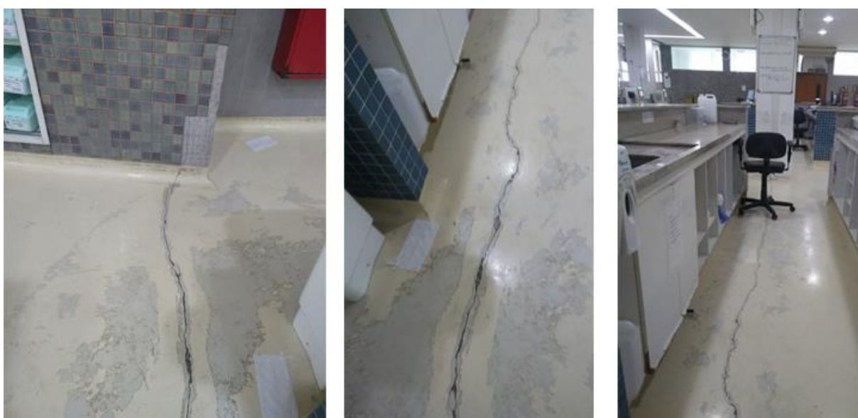
Figura 109 – Patologia da Sala 1 de HD
