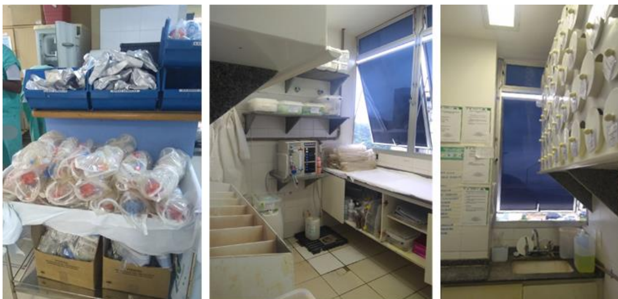
Figura 100 – Sala de limpeza de dialisador
