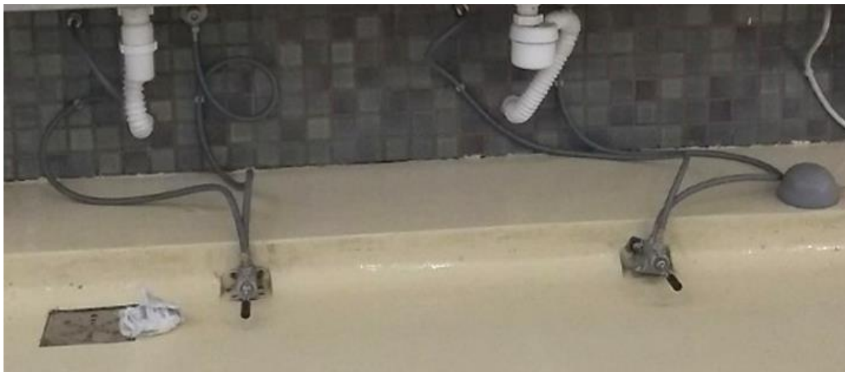
Figura 111 – Vazamento no piso na sala de HD
