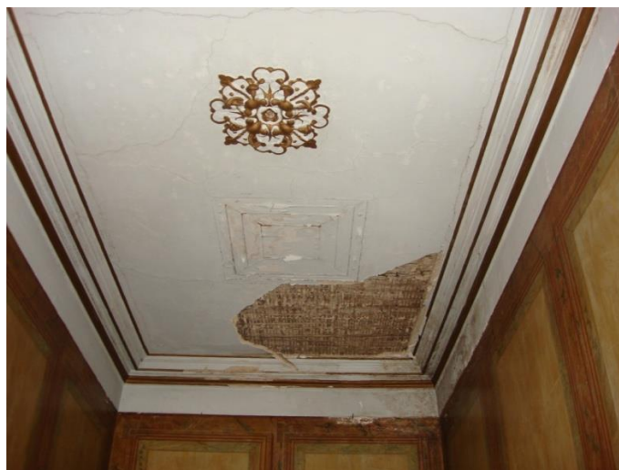
Figura 71: Perda de parte do estuque na caixa de escada.
