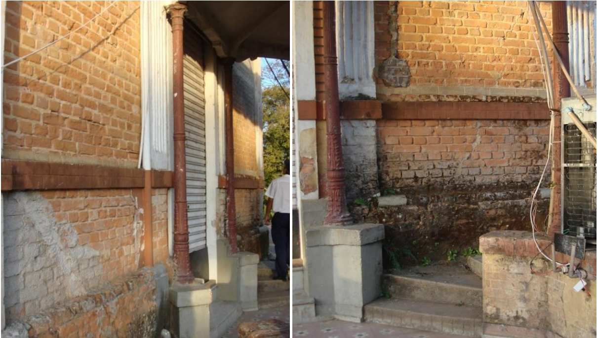
Figura 89 e figura 90: Presença de microflora nos tijolos da parede.
