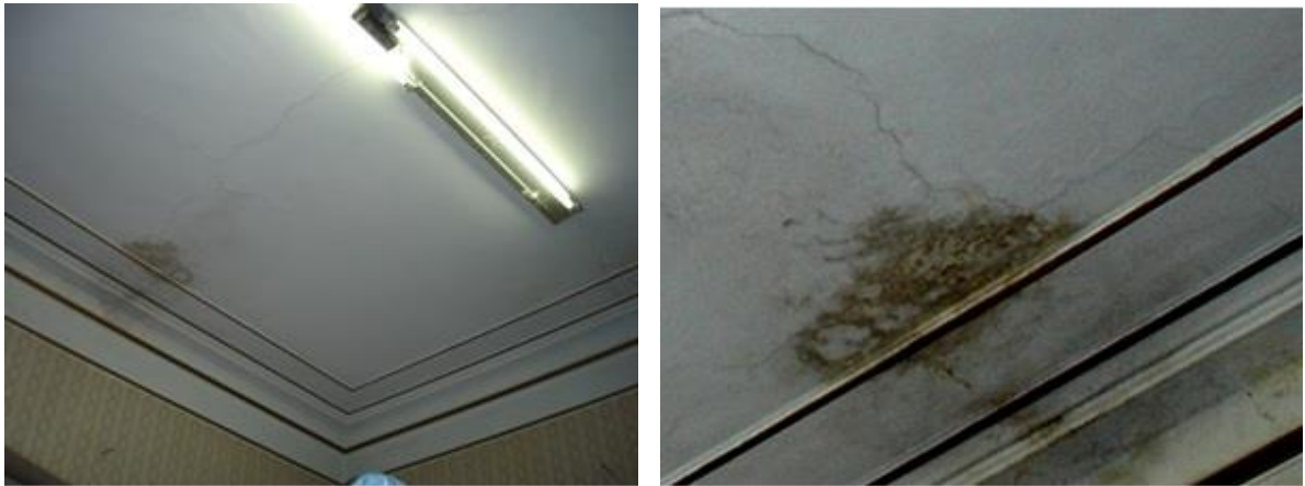
Figura 74 e figura 75: Danos no forro do torreão
