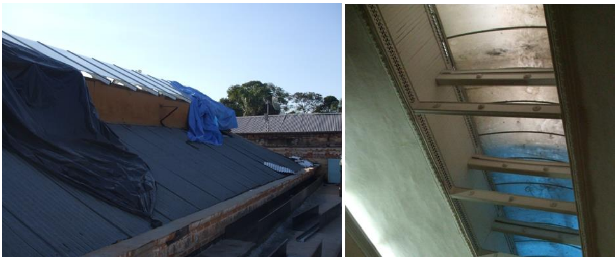
Figura 98 e figura 99: Substituição das telhas do lanternim e sobrecobertura usada durante a execução.
