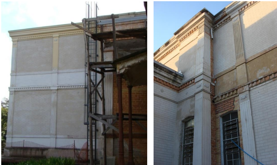
Figura 87 e figura 88: Fachada posterior não concluída.
