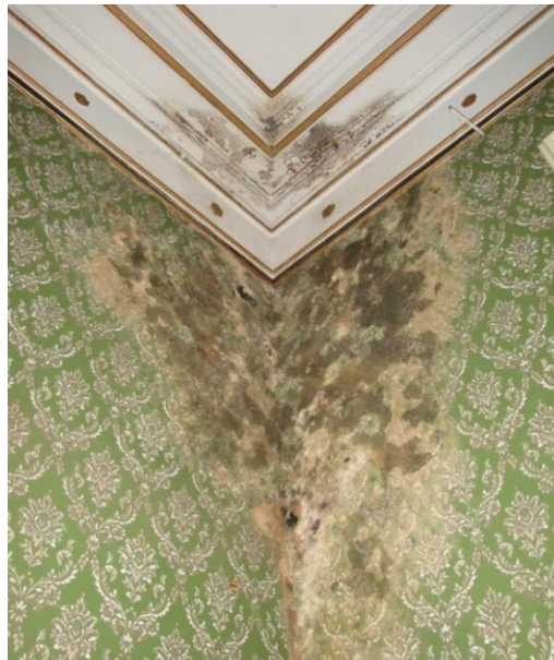
Figura 76: Infiltração nas paredes internas da Villa, comprometendo o papel de parede.
