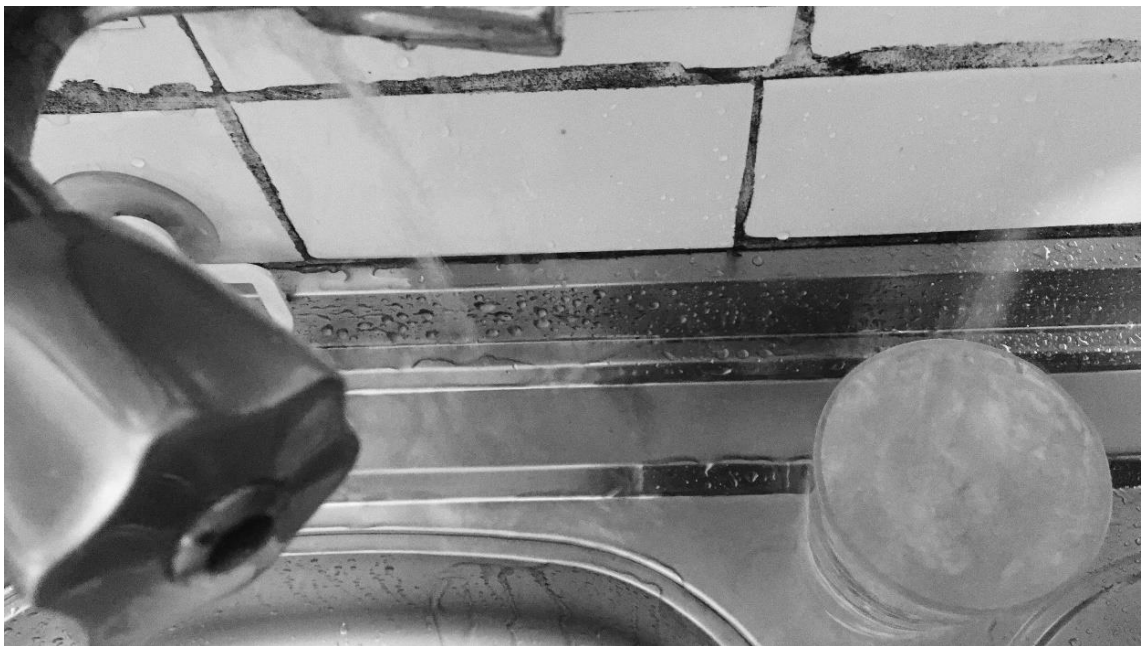
Figura 2: vazamento em 3 pontos
