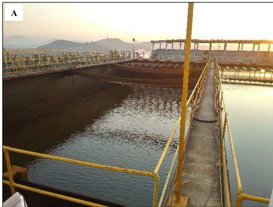
Figura 8 – A) Foto da unidade de decantação; e B) Foto das calhas de coleta de água decantada
