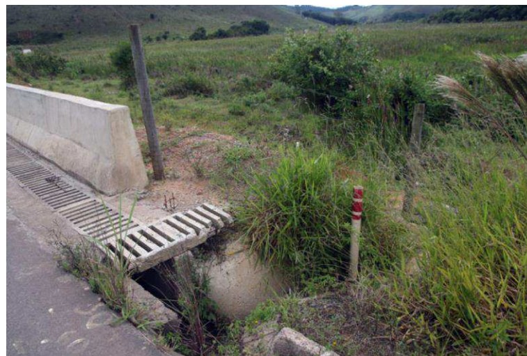
Figura 10 – Canaleta destinada ao escoamento de água e outros produtos, sem caixa coletora
