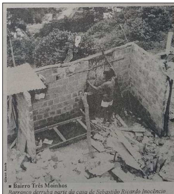
Figura 127: Ocorrência de deslizamento no bairro Três Moinhos- RU Linhares
