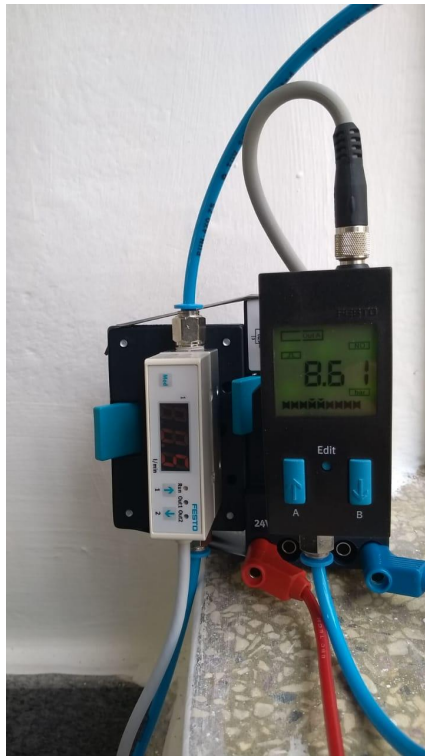
Figura 12 – Medidores de pressão e vazão digitais utilizados no experimento de perda de carga
