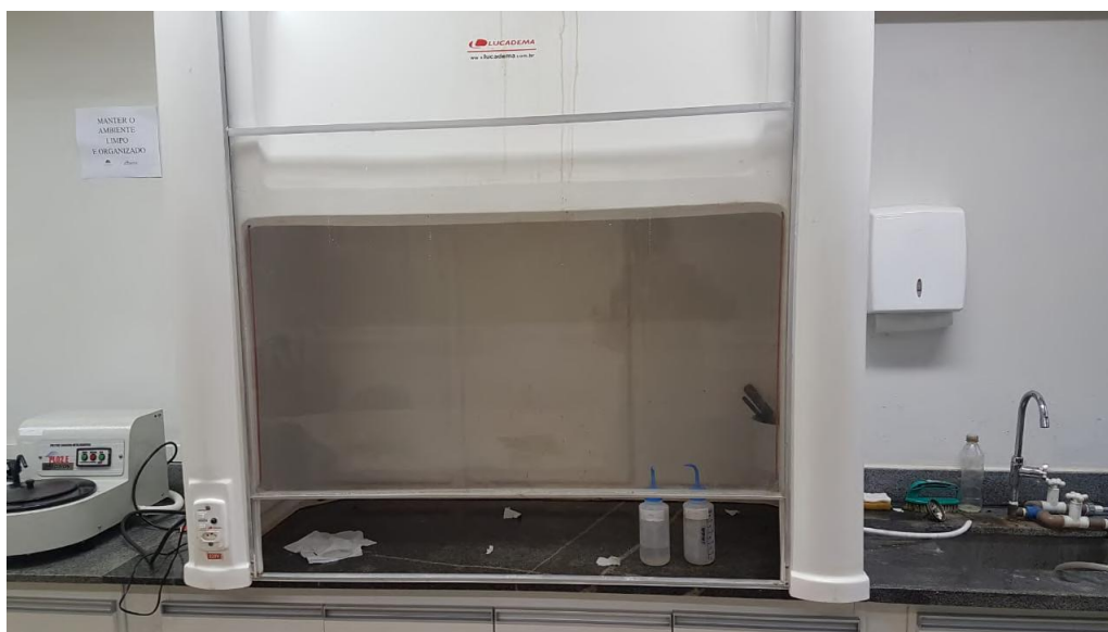
Figura 30 – Capela para realização de ataques químicos
