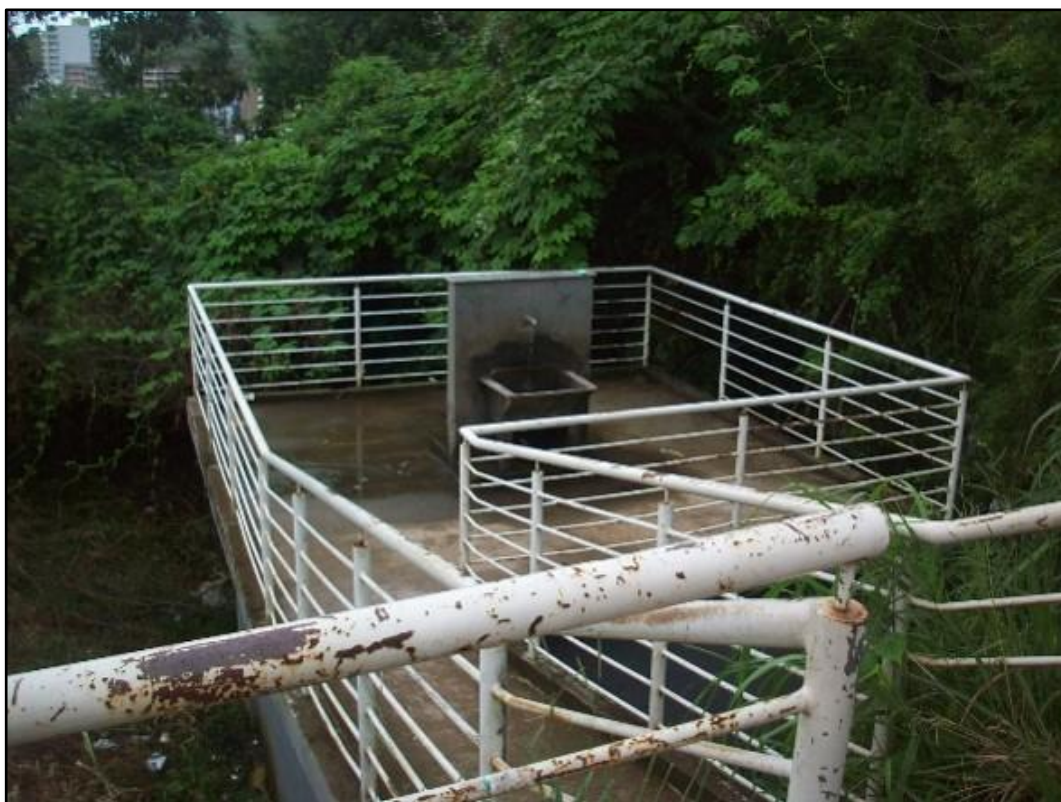
Figura 18 – Nova alocação da bica d'água, retirada da Av. Itamar Franco, Dom Bosco, Juiz de Fora
