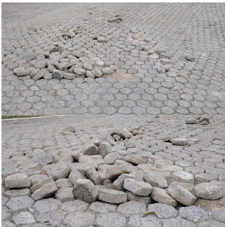
Figura 16 – Trecho em que peças pré-moldadas de concreto foram deslocadas.
