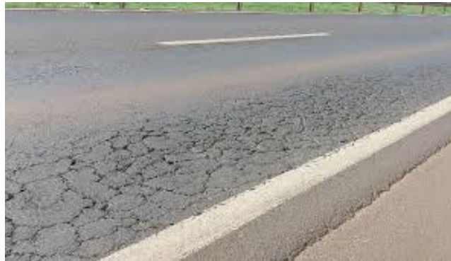
Figura 36 – Pavimento deteriorado em razão da repetição de deformações elásticas.
