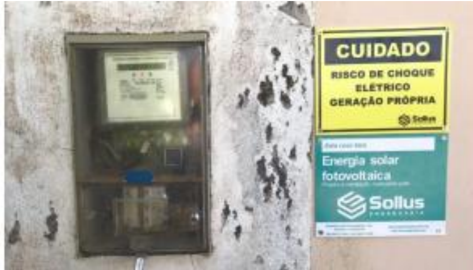
Figura 05 – Placa de geração de energia
