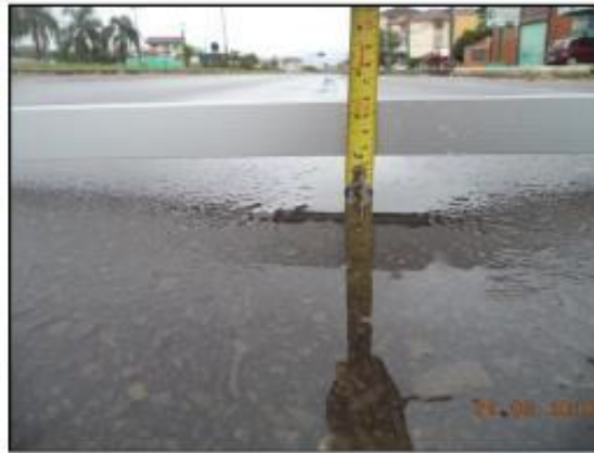
Figura 23- Afundamento de trilha de roda em um trecho de uma rodovia.
