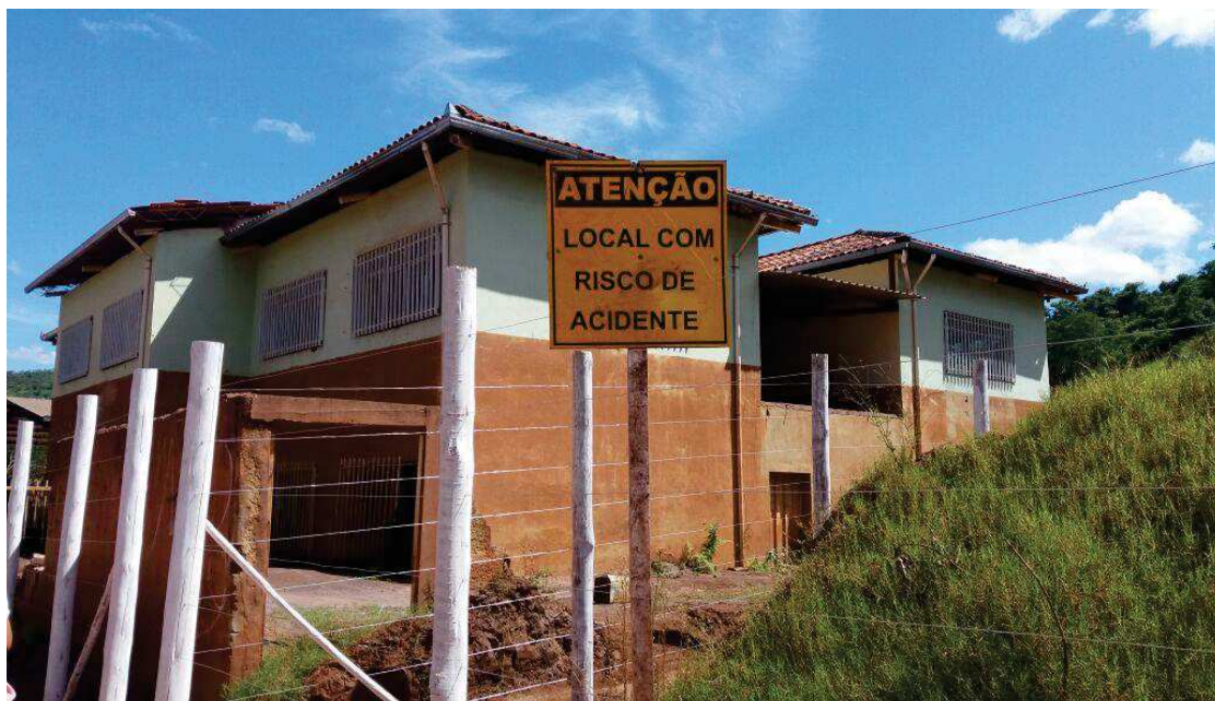
Figura 6. Escola da comunidade Rural de Paracatu de Baixo destruída pela barragem
