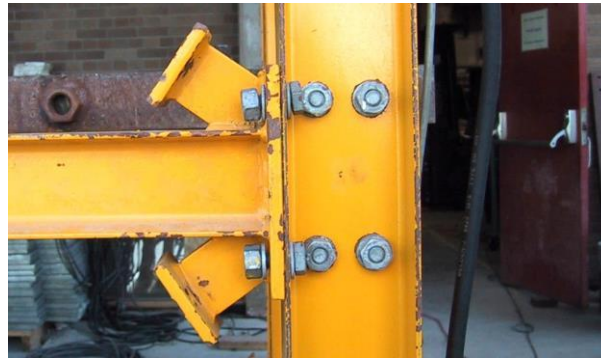
Figura 38 – Detalhe do afrouxamento de parafusos
