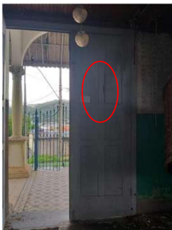
Figura 27: Fendilhamento na porta principal.
