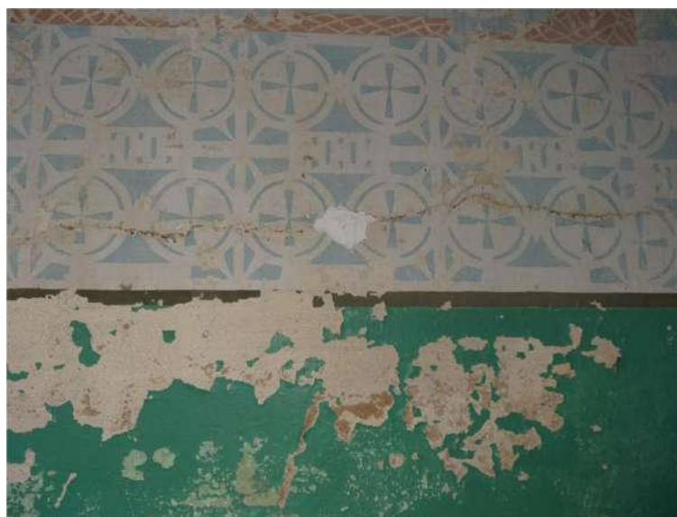
Figura 16: Perda de camada pictórica e fissura oriunda de movimentação higroscópica.
