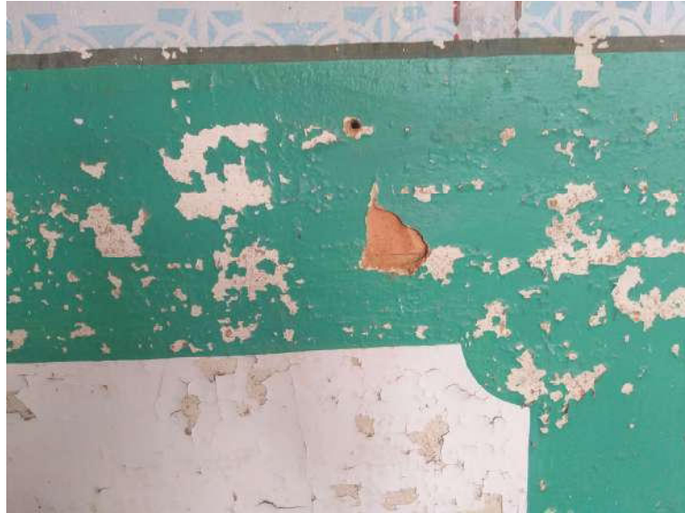
Figura 17: Pontos com desprendimento do reboco e do emboço.
