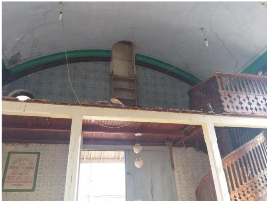
Figura 22: Coro, escada, balaustrada e guardacorpo danificados.
