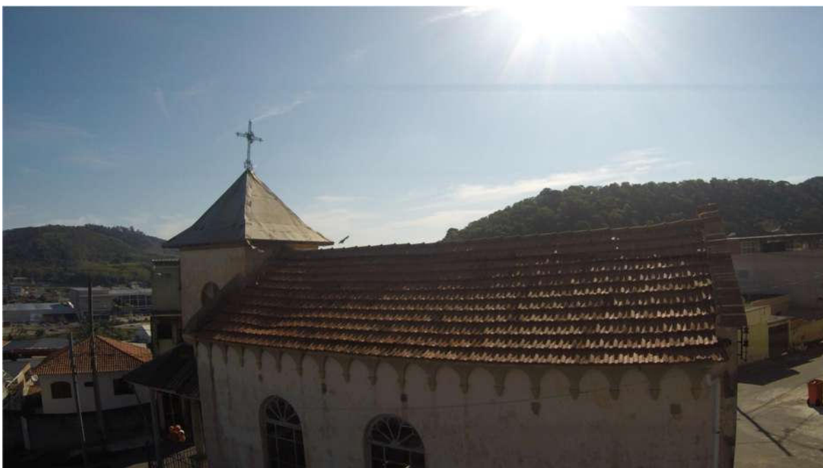
Figura 47: Abaulamento da cumeeira e da água direita.
