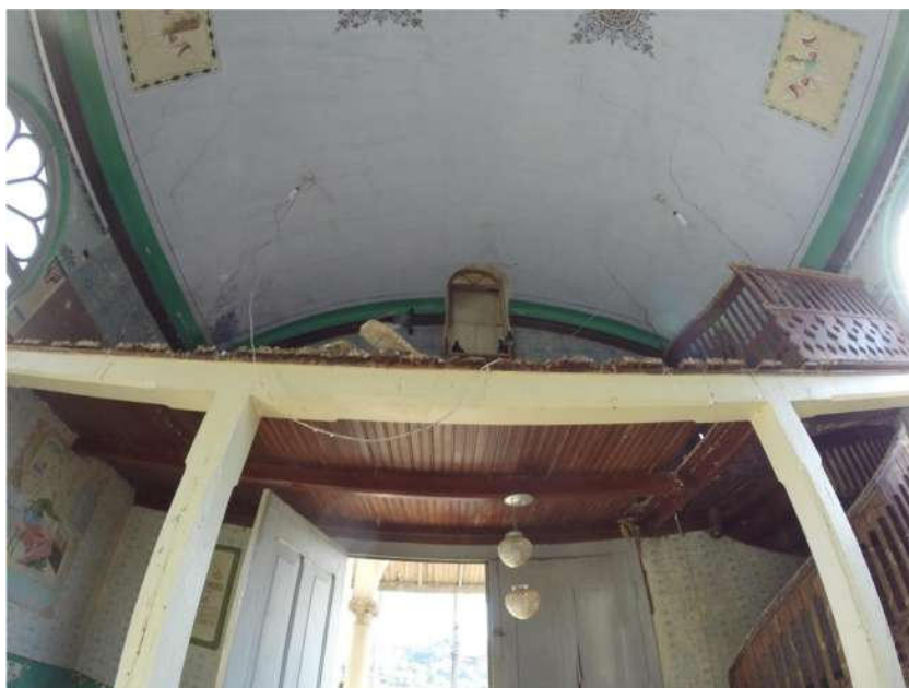
Figura 32: Fissuras no forro de estuque.
