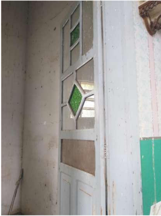
Figura 29: Portas com vidros faltantes.
