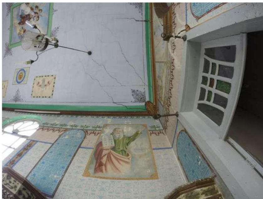
Figura 31: Fissuras no forro de estuque.
