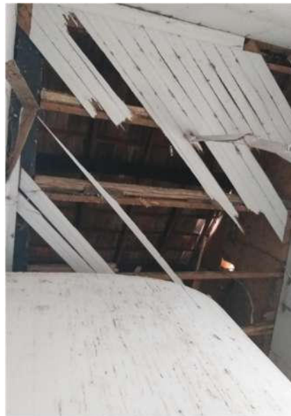
Figura 36: Forro da sacristia degradado.
