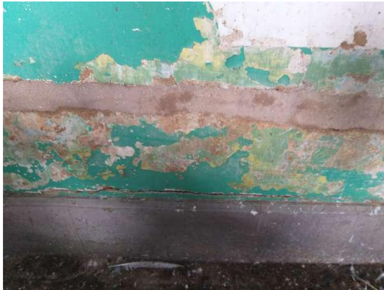
Figura 18: Intervenção inadequada para passagem de tubulação.
