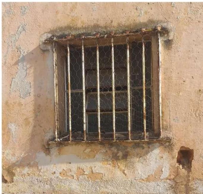
Figura 26: Caixilhos de ferro oxidados.
