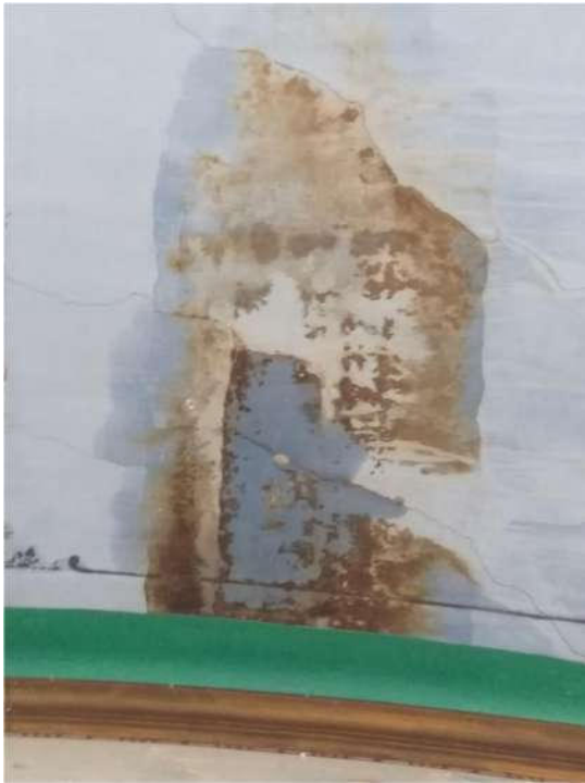
Figura 33: Mancha de umidade e microflora no forro.
