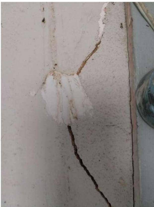
Figura 43: Movimentação verificada no testemunho 1.
