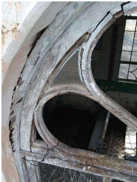
Figura 25: Fendilhamentos e xilófagos.
