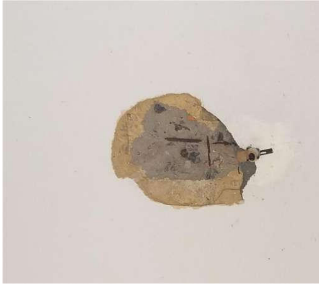
Figura 13: Exposição e corrosão da armadura da laje.
