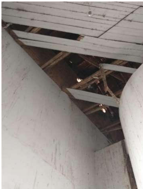
Figura 35: Forro da sacristia degradado.
