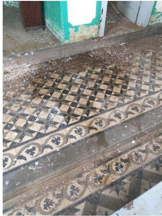
Figura 34: Empoçamento devido à infiltração.
