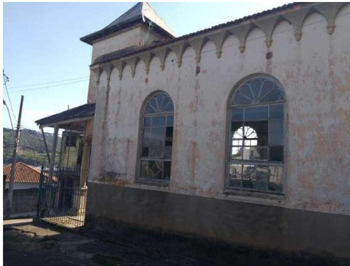
Figura 9: Danos na fachada lateral esquerda.
