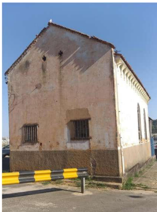
Figura 10: Danos na fachada posterior.
