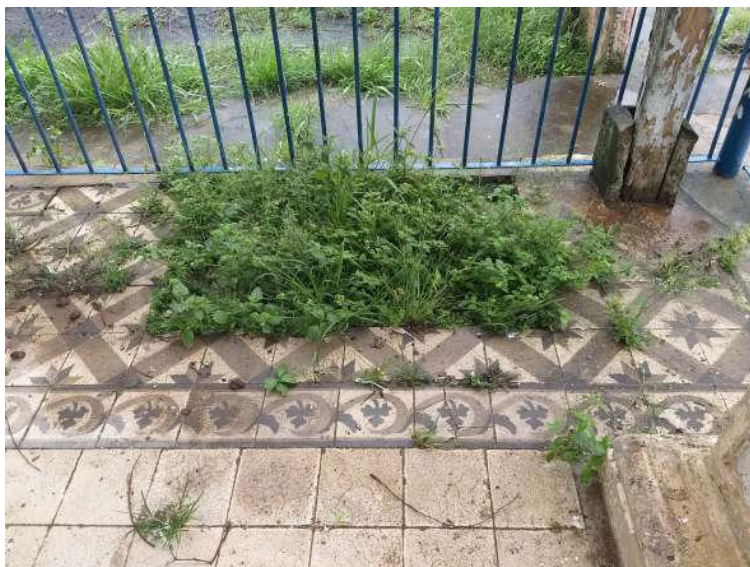
Figura 15: Peças faltantes no piso e presença de vegetação de pequeno porte.
