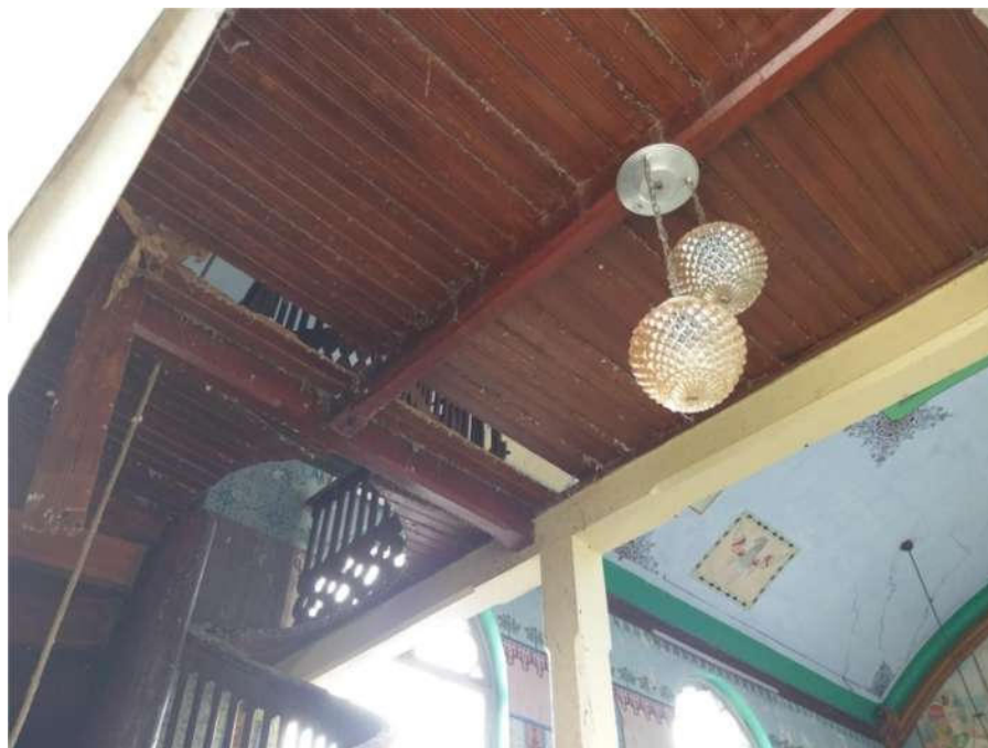
Figura 23: Laminado do coro danificado e com peças faltantes.
