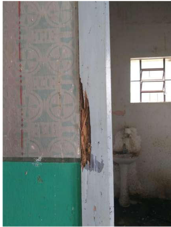
Figura 30: Presença de xilófagos nas portas.
