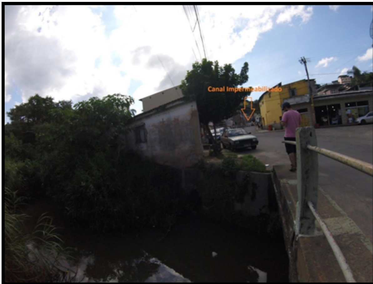
Figura 52- Em primeiro plano o canal de 4ª ordem do córrego Humaitá e em segundo plano a rua Geraldo Scaldine Machado, um canal de 1ª ordem impermeabilizado.
