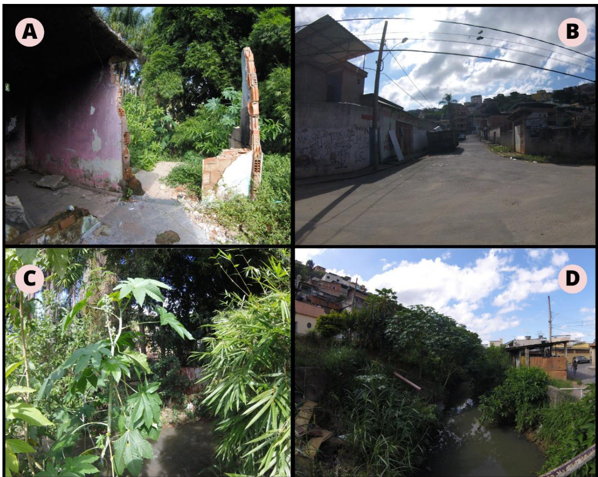
Figura 17 - A- Casa na margem do rio totalmente destruída por, provavelmente, inundação. B- Casas de construções mais humildes no bairro Jardim Natal. C- Leito do rio visto dentro da casa destruída. D- Margens do rio completamente tomadas por mato e casas inacabada.
