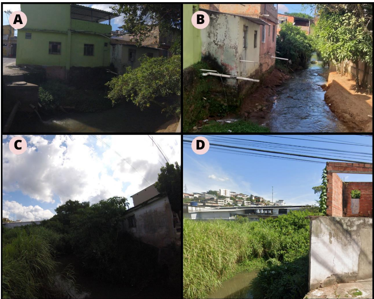
Figura 18 - A- Casas populares no leito do córrego Humaitá com marcas de umidade e canos jorrando escotos. B- Casas na margem do córrego Humaitá com canos liberando água com sabão C- Leito do córrego Humaitá com uma casa marcada por umidade e com grandes rachaduras. D- Margens do rio completamente ocupadas por mato, casa inacabada e galpões.
