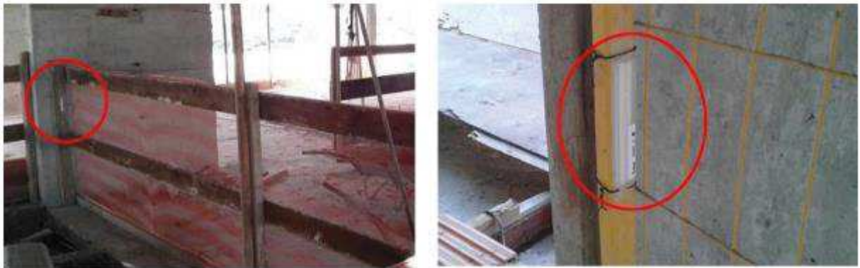
Figura 29 - Tag's RFID instaladas em guarda corpo (EPC - Equipamento de Proteção Coletiva) no canteiro de obras
