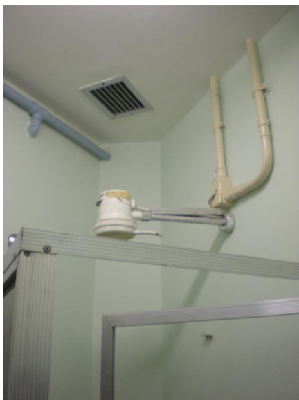
Figura 35 – Detalhe que mostra o chuveiro e a exaustão mecânica (fonte: a autora).
