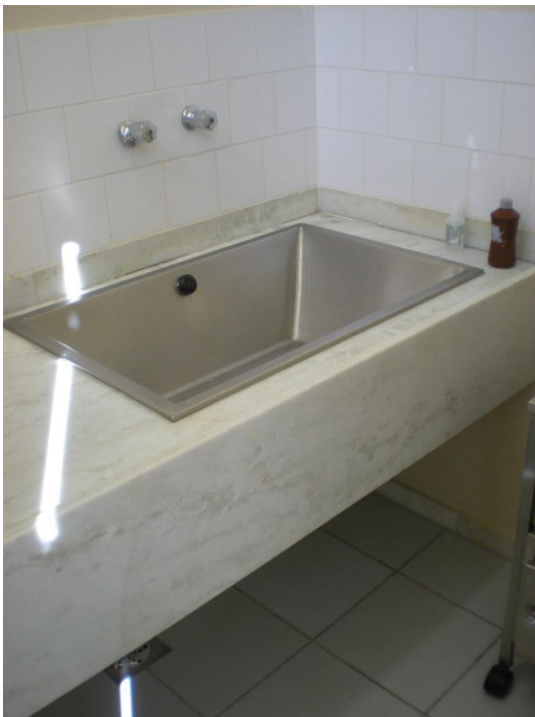
Figura 31 – Banheiro embutida (Fonte: a autora).
