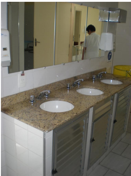
Figura 99 – Detalhe das pias do banheiro das enfermarias (fonte: a autora).
