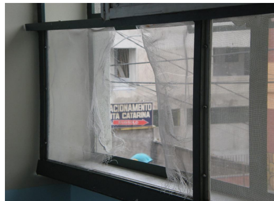
Figura 26 – Detalhe da tela de proteção danificada (Fonte: a autora).
