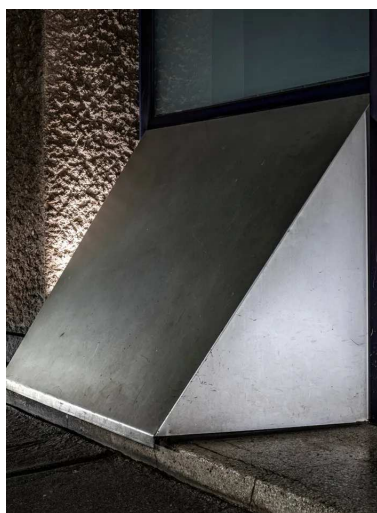
Figura 28 - Elemento de metal sobre calçada. 28
