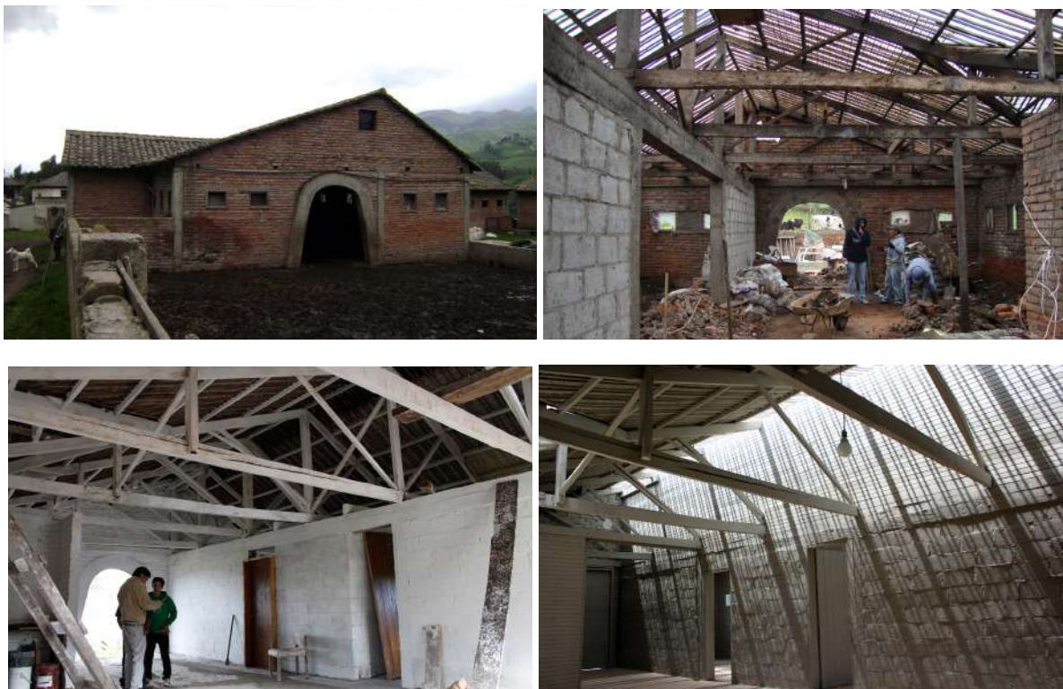
Figuras 37-41 - Al Borde / Ladrillos, bloques y otros elementos abandonados y parches / Mocha, Ecuador (2012)
