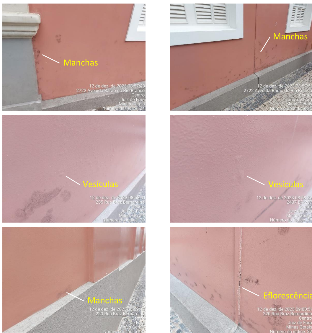
Figura 39: Fotos das anomalias presentes após reparo e restauro
