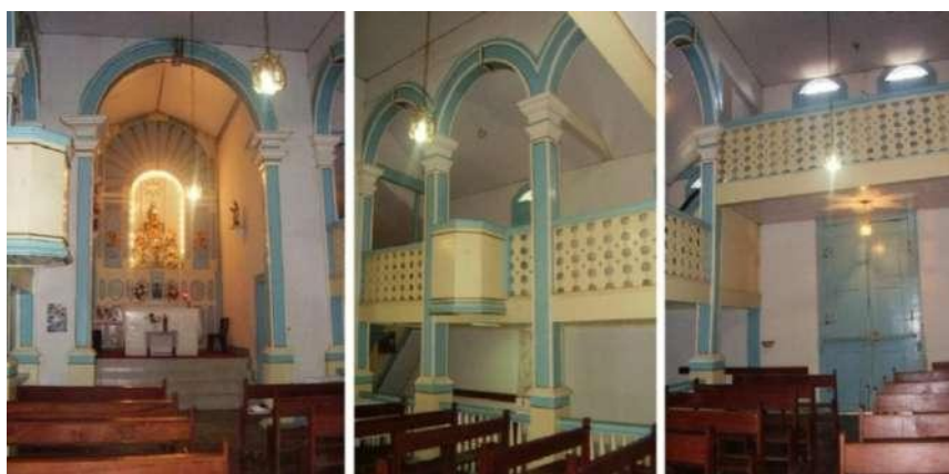
Figura 27: Igreja de Nossa Senhora do Rosário. Vista do interior: nave, capela-mor, corredores laterais, tribuna e coro. Descoberto/MG. Fotos e montagem: Elza Vieira - Julho/2023.
