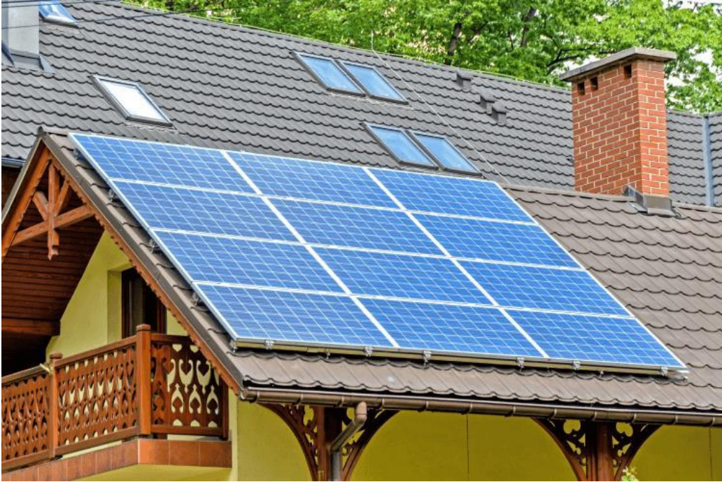
Figura 61 - Placas solares no teto de uma residência.
