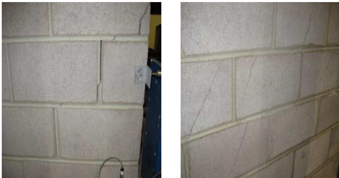
(a) Trinca nas juntas de argamassa, entre os blocos estruturais
