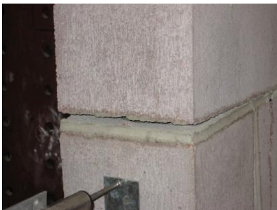
a) Trinca na extremidade inferior tracionada
