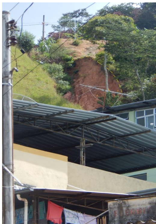
Figura 38: Cicatriz de escorregamento (pontilhado na cor amarela) no bairro Vale dos bandeirantes. Fonte: do autor, 2015.
