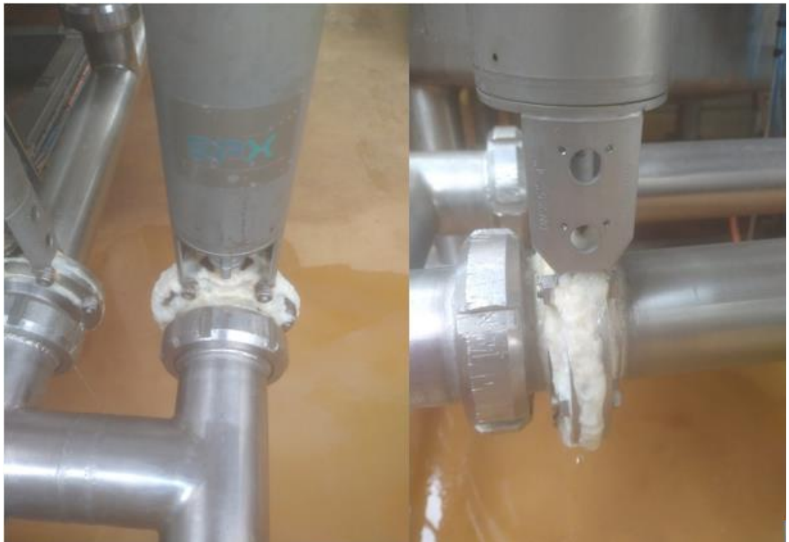
Figura 2 - Biofilme em válvula pneumática
