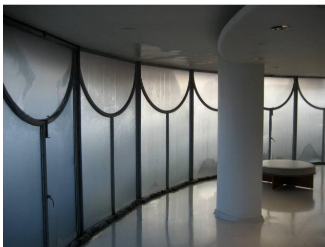
Figura 4.3 - Condensação no interior do museu (JEROME, 2009).
