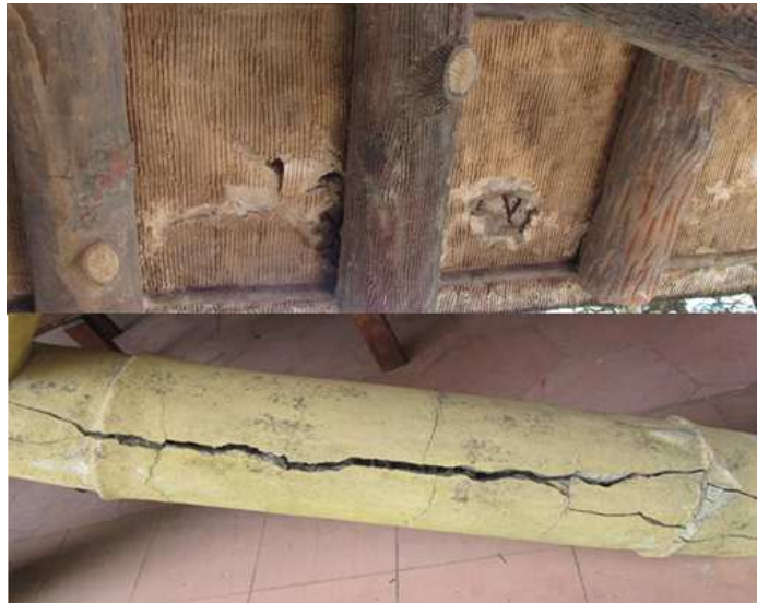
Figura 36 — Fotomontagem de desprendimentos e fissuras na argamassa do Quiosque.
