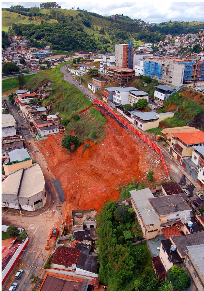
Figura 55 - Aspecto da encosta escorregada – Bairro Santa Tereza. Foto aérea de Olavo Prazeres, de 07/04/08
