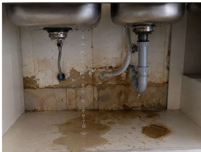
Figura 5 - Exemplo de umidade accidental provocada por falha em tubulação hidrossanitária.
