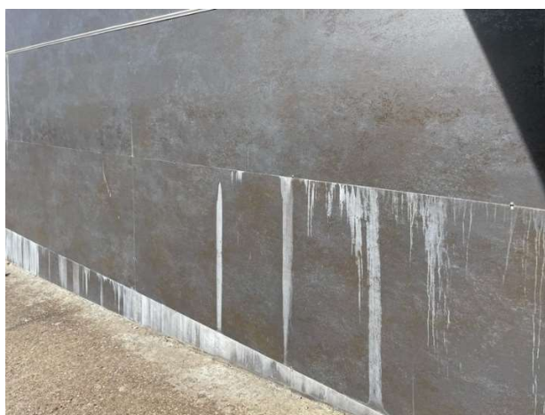
Figura 1- Revestimento com eflorescência.
