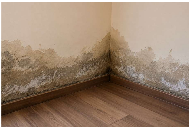
Figura 6 - Danos por umidade ascensional na base da parede interna.
