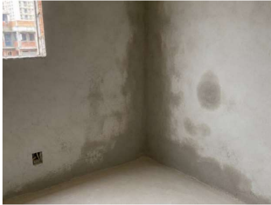
Figura 3 - Umidade de obra em parede recém-rebocada.
