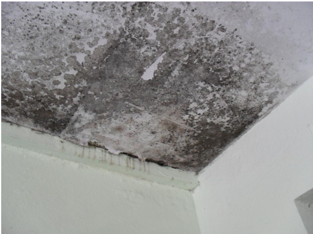
FIGURA 12 - Infiltração pela laje de cobertura
