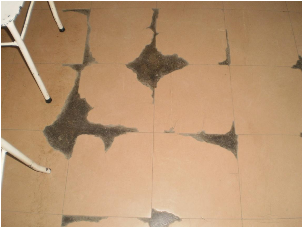
FIGURA 18 - Desgaste do piso devido a resistência a abrasão inadequada
