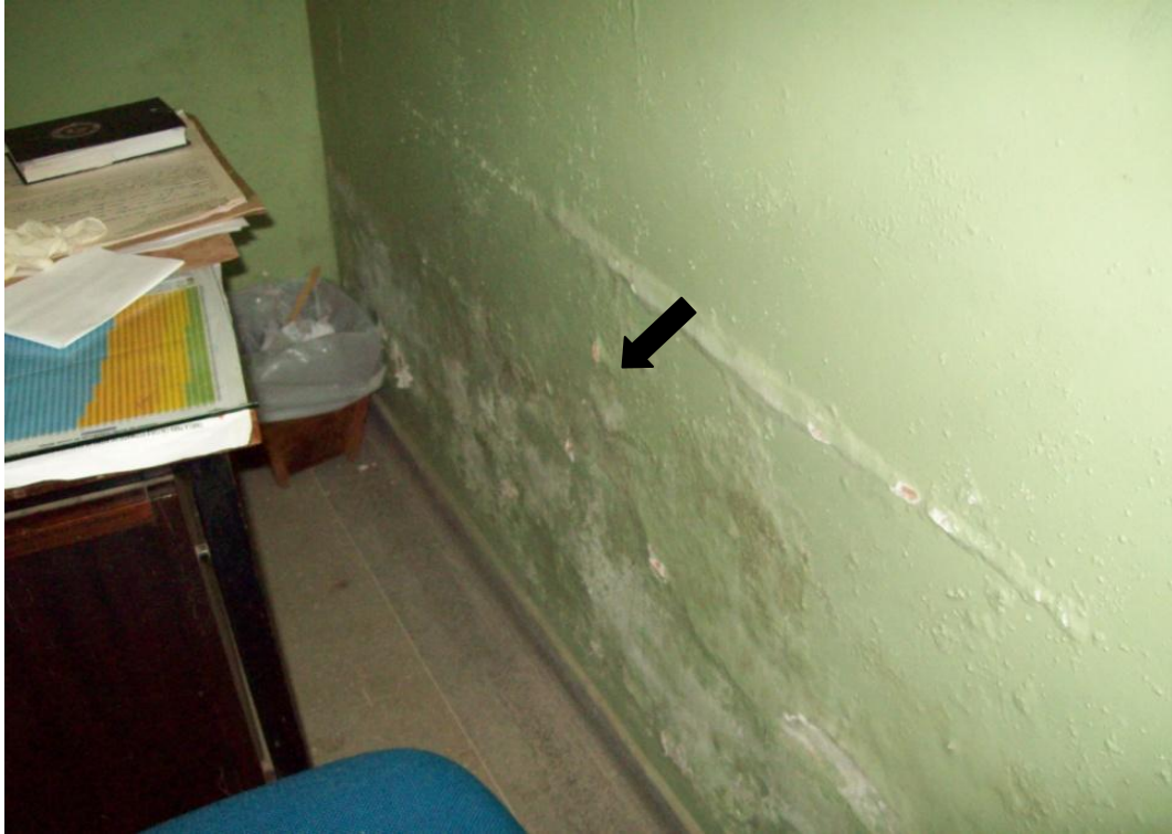
FIGURA 11 - Umidade ascensional ocasionando deterioração da pintura e do revestimento
