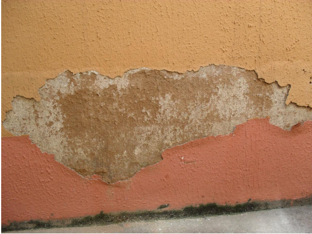
FIGURA 15 - Deslocamento do revestimento
