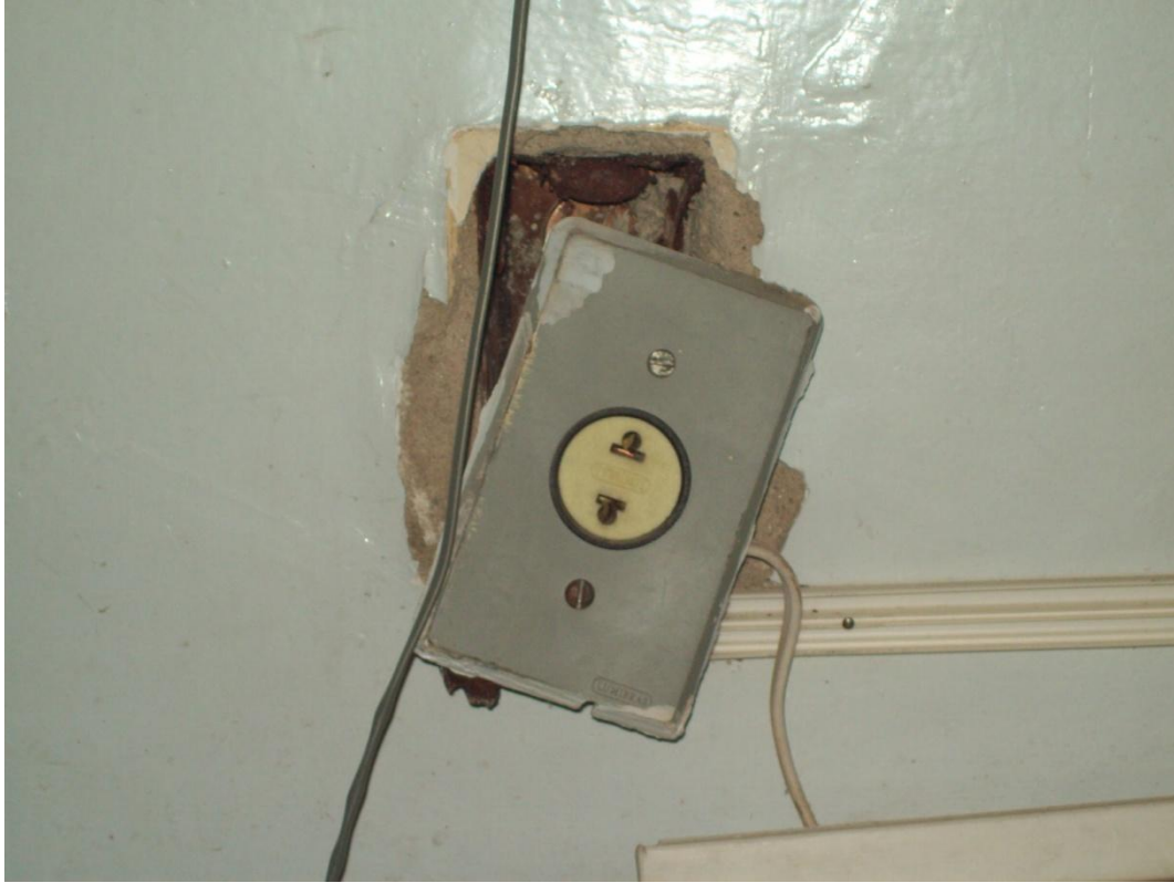
FIGURA 17 - Elemento de instalação elétrica danificado
