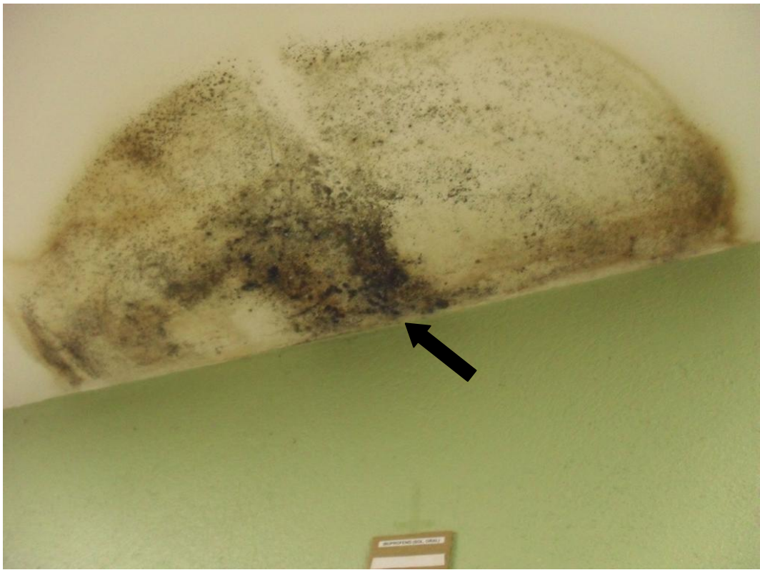
FIGURA 16 - Presença de microorganismos devido à umidade
