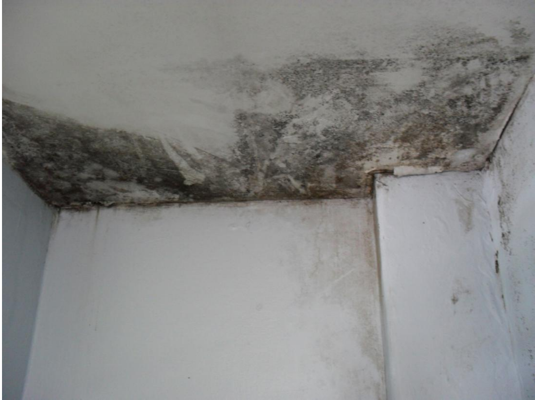
FIGURA 13 - Infiltração pela laje de cobertura
