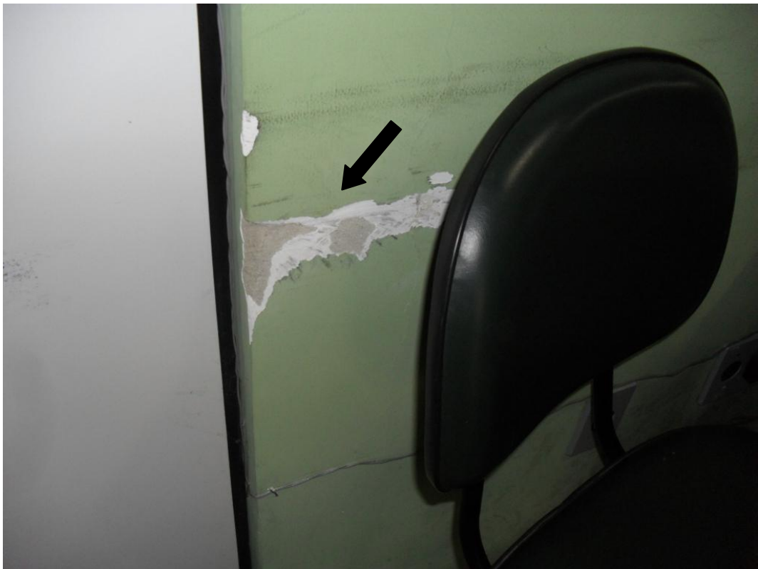
FIGURA 14 - Deterioração da pintura devido ao atrito de móveis
