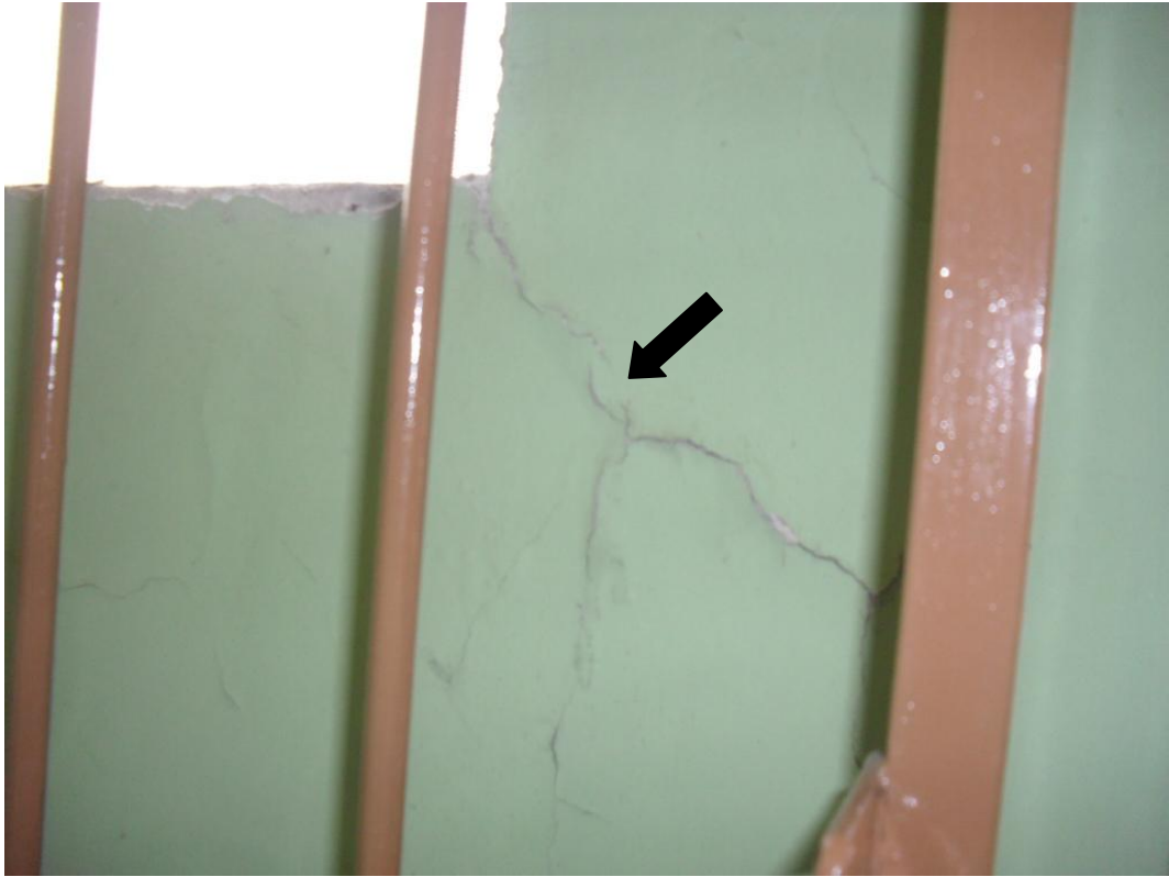
FIGURA 19 - Trinca devido à ausência de contra-verga
