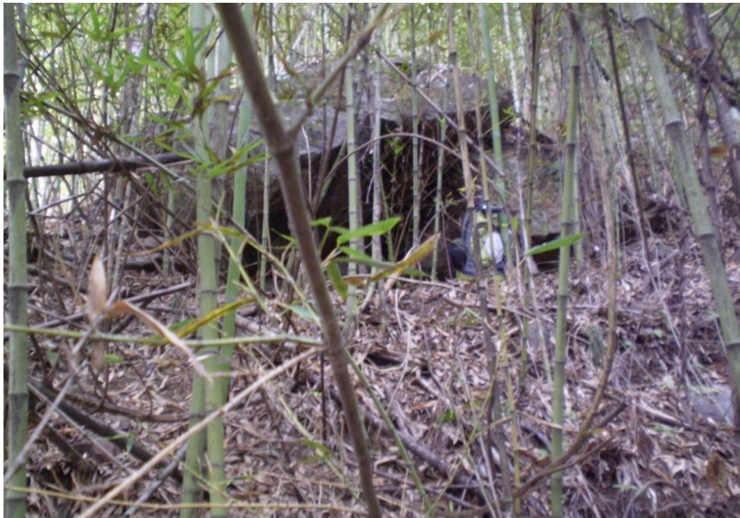
Figura 19 - Fotografia do bloco de rocha instável situado no acesso à trilha norte no santuário da Rua Halfeld
