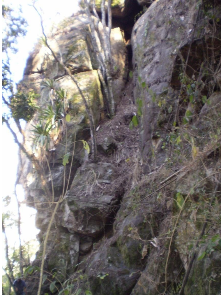
Figura 22 - Fotografia dos blocos de rocha muito instáveis localizados nos fundos do antigo Hospital São Domingos
