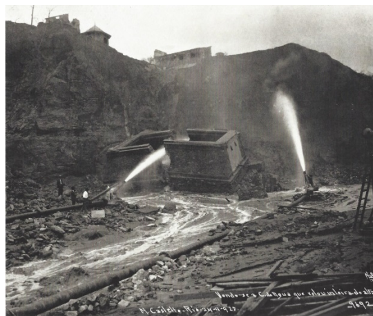
Imagem 51: Augusto Malta, Arrasamento do Morro do Castelo utilizando-se jatos de água bombeada do mar, 1922.
