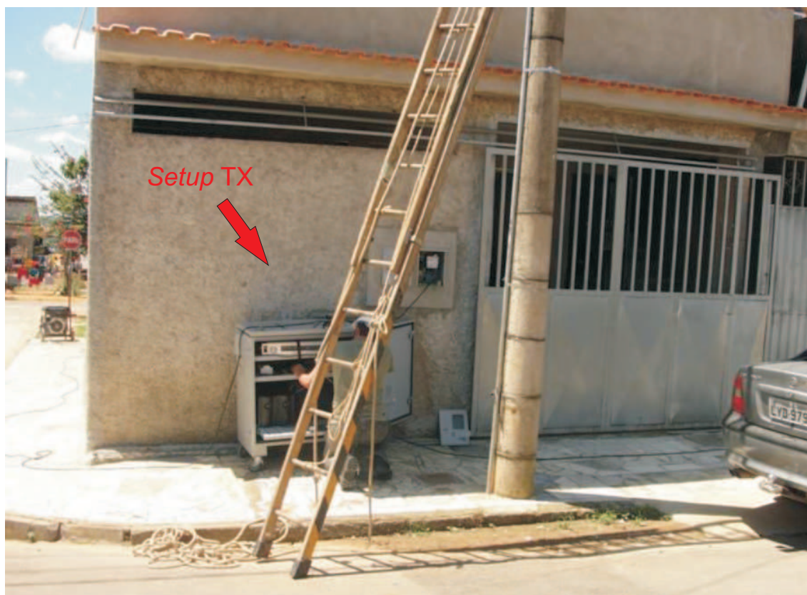
Figura 15: Setup TX instalado próximo ao medidor de energia elétrica do consumidor.
