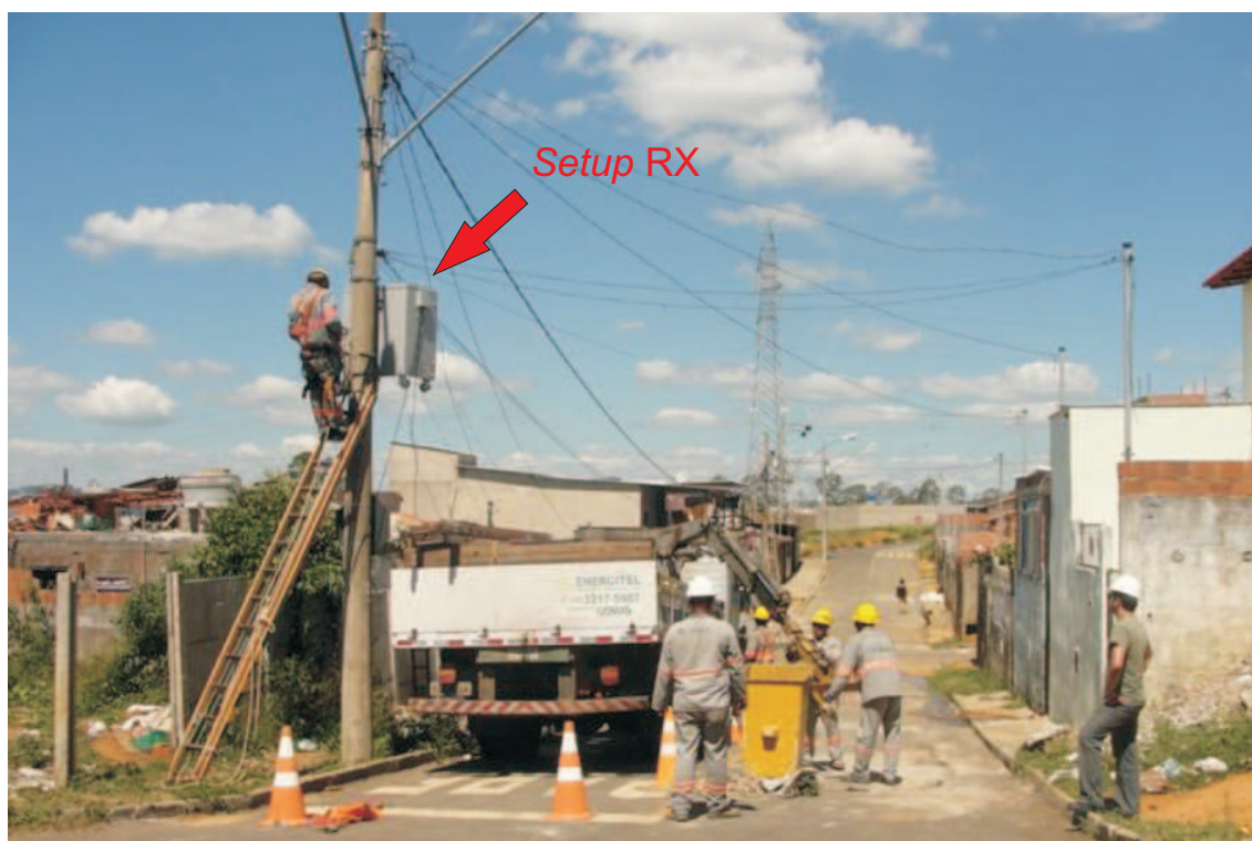
Figura 14: Setup RX instalado em poste sem tráfego.
