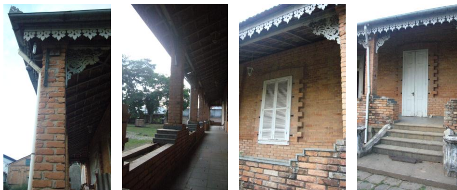
Figura 72: Detalhes da “Casa dos Hóspedes” da Cia. Têxtil Ferreira Guimarães (Fotos Claudia Gaspar Cimino, 2013).
