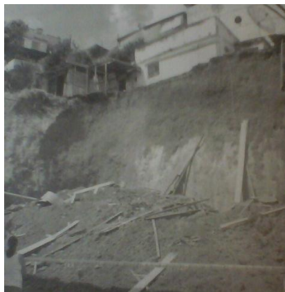
Figura 2: Escorregamento no São Tarcísio. Fonte: Tribuna, 2008.
