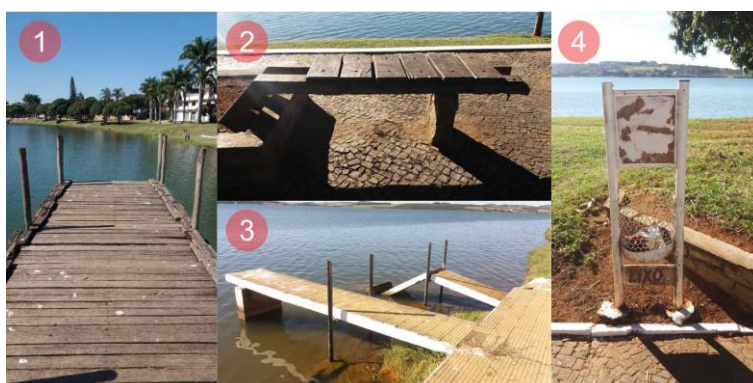
Figura 64: Desgaste do mobiliário urbano existente.
