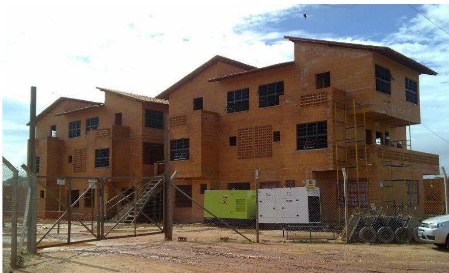
Figura 3: Residencial Liberdade: Conjunto Habitacional na região do canal da Tucunduba em Belém Fonte: ROCHA 4
