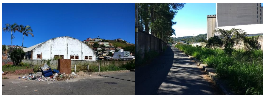
Figura 40: Presença de lixo e mato nas margens do Córrego Cachoeirinha Fonte: Arquivo pessoal
