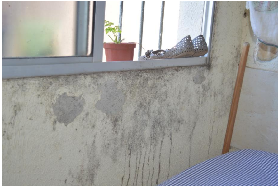
Figura 22 - Manchas de umidade na área de serviço.
