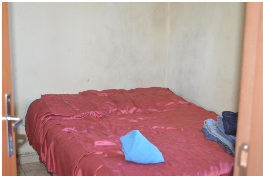
Figura 23 - Umidade nas paredes dos quartos.
