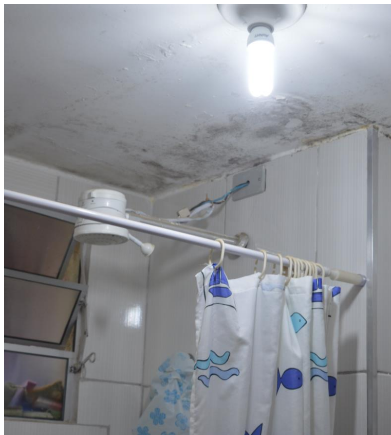
Figura 20 - Infiltrações no forro do banheiro.
