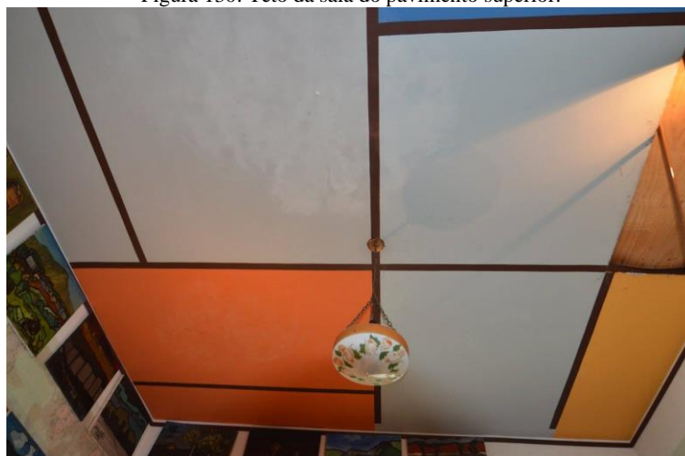
Figura 130: Teto da sala do pavimento superior.
