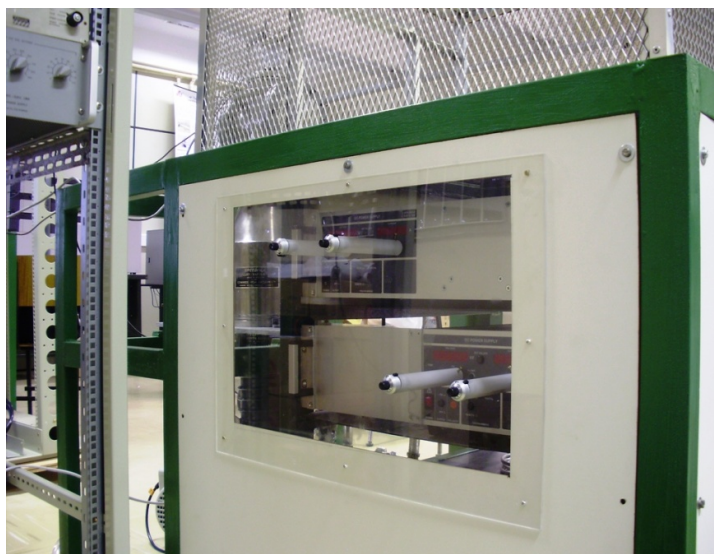
Figura 4.18 Visão panorâmica dos racks interno e externo, do rack comercial 19 polegadas e dos equipamentos eletrônicos
