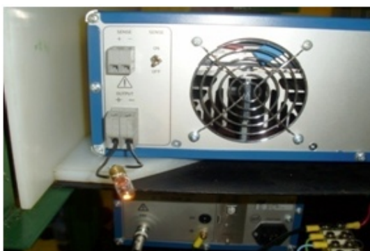
Figura 4.16 Teste inicial de verificação do funcionamento da fonte de corrente
