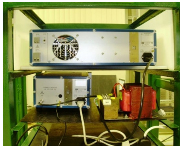
Figura 4.15 Ligações elétricas envolvendo o transformador de isolamento B, a fonte de tensão de 0 – 6,5 kV e a fonte de corrente no interior do rack interno
