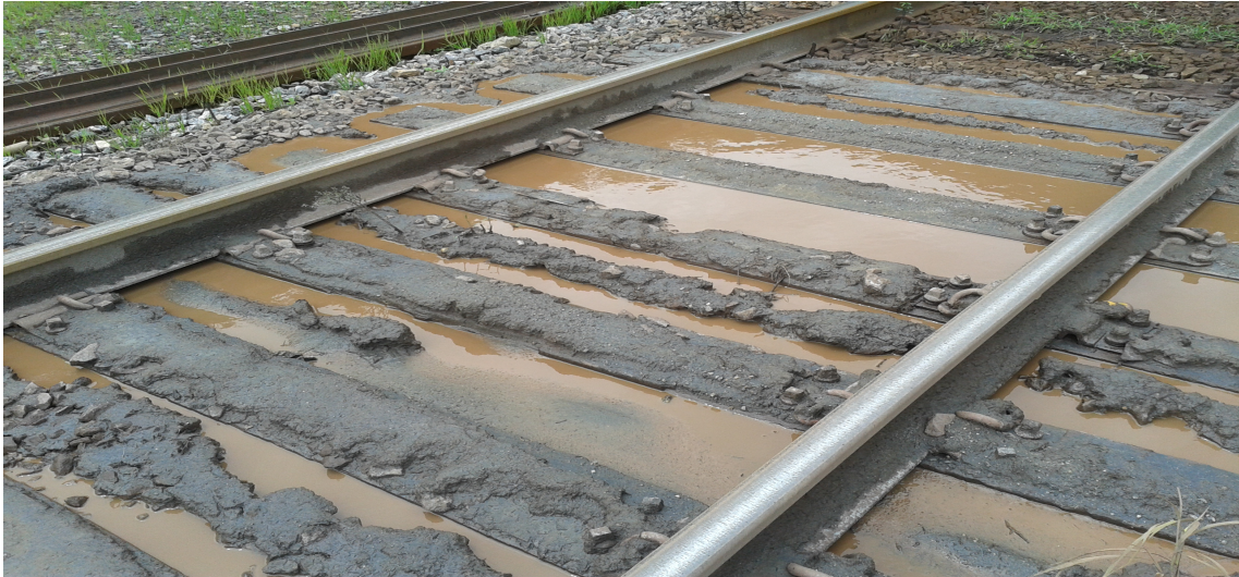
Figura 2.7: Ponto com acúmulo de sedimentos e inundação de via.
